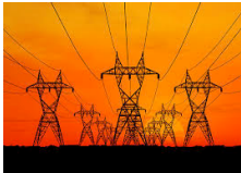
Distribuzione dell'energia elettrica
